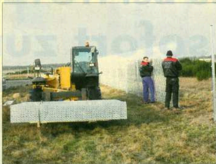
An die 2040 Pfosten wurden 2040 Gittermatten montiert. Termingerechtheit wurde die Kunrauer Firma damit fertig. Foto: Lübbers/msh
